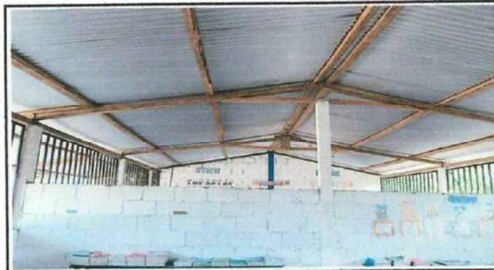
Foto 4: Se observa división de aulas incompleto.
