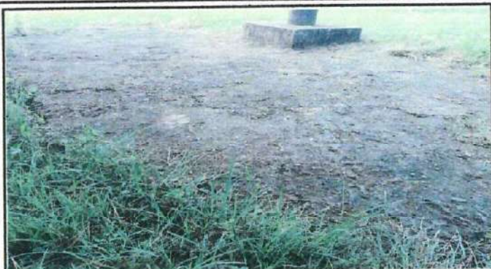
Foto1: Se observa losa del patio en mal estado
