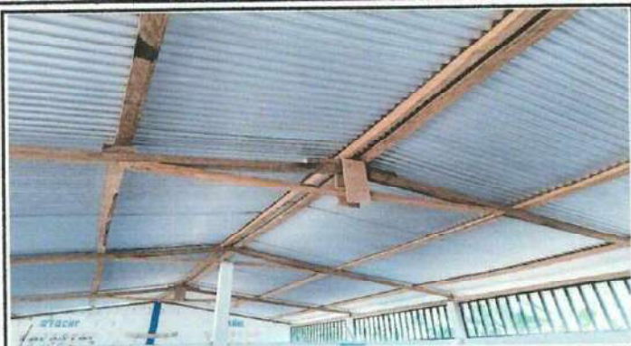
Foto 1: Se observa el soporte de estructura de techo con mala instalación y demasiado espacio entre costaneras.
