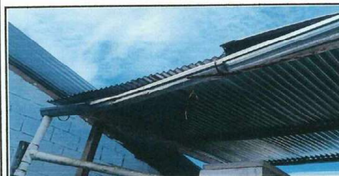
Foto 5: Se observa línea pluvial en mal estado y dañada
