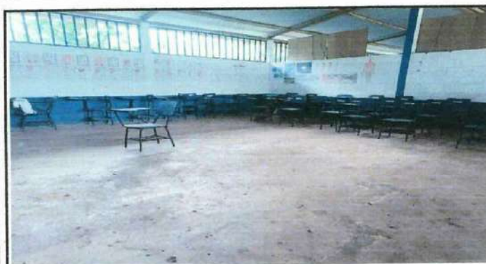
Foto 3: Se observan el piso de concreto con humedad
